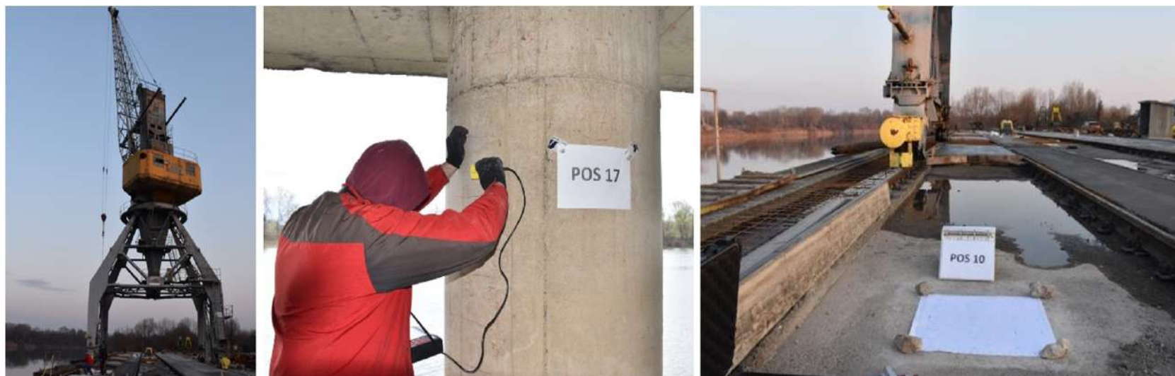
Слика 12. Процјена стања АБ конструкције вертикалног кеја – пристаниште у Луци Брчко
